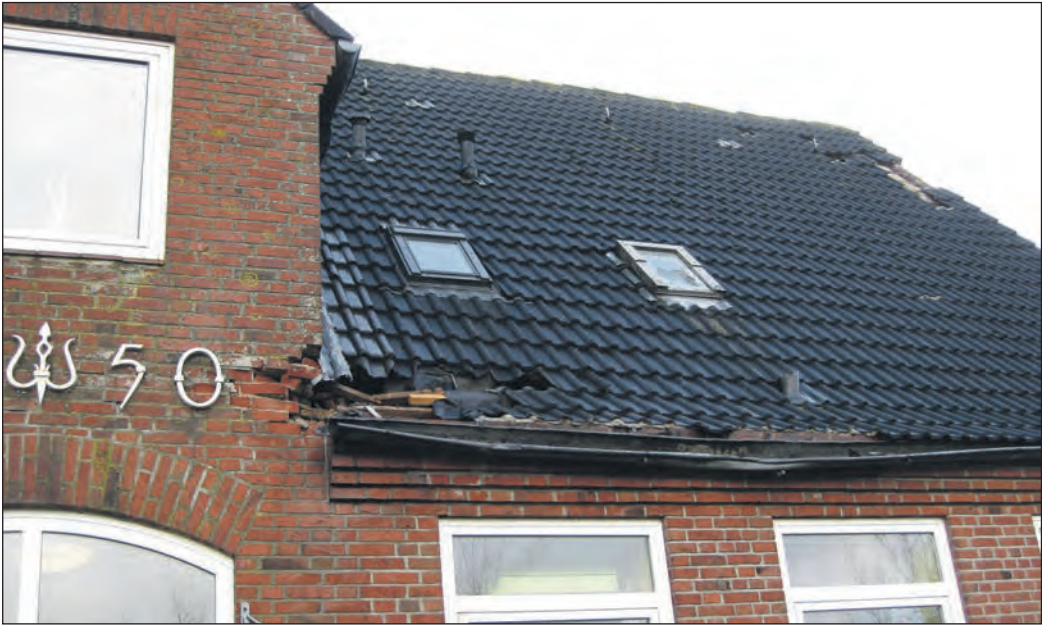
Tag og ydervæggene er beskadiget i børnehaven i Aventoft.
