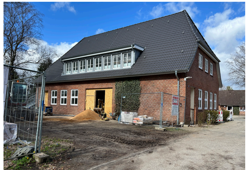
En hel underetage af skolen i Store Vi er taget ud af brug, indtil saneringen er gennemført. Foto: Trine Flammig
